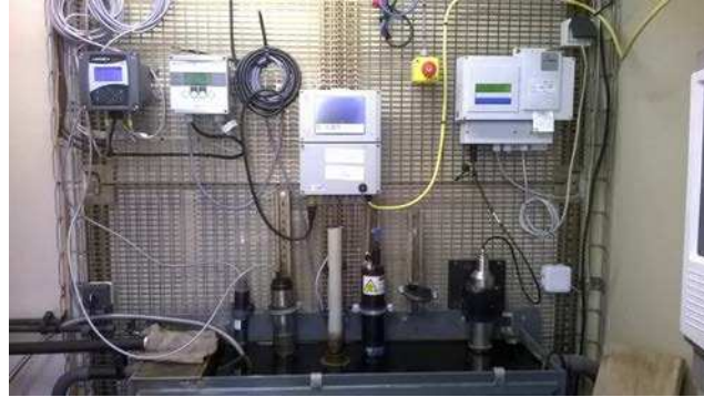
Figure 1. Intérieur de la station de mesure avec le bac intermédiaire dans lequel sont plongés les différents capteurs
